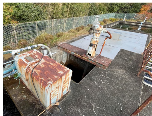
設備の劣化（影戸浄水場）
