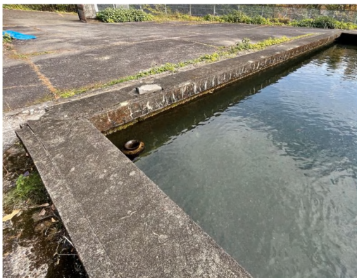
緩速ろ過地の劣化（小ヶ倉浄水場）
