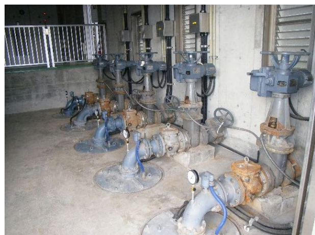
挟間地域：取水場 ポンプ室
