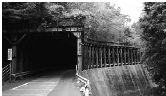
死亡事故が起きた県道湯平温泉線トンネル現場
